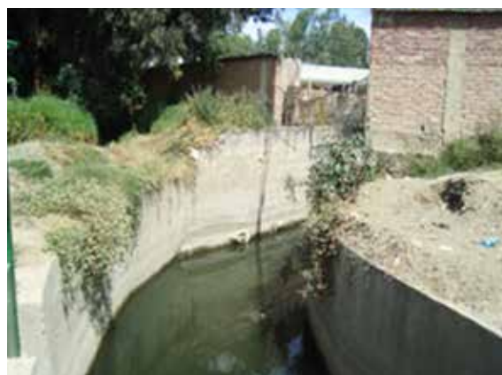
Fotografía 2. Invasión a las áreas de protección de riberas
